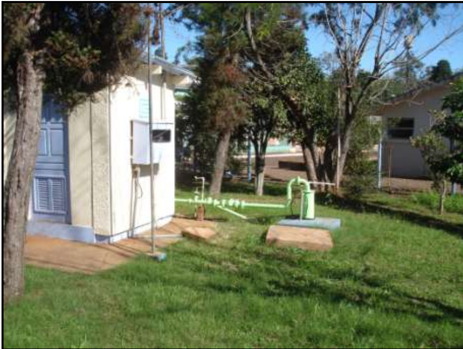
Figura 4 – Poço Corsan Bairro Santa Lúcia Fonte: Cerne Ambiental
