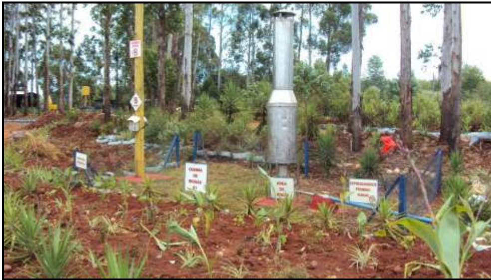
Figura 30: Sistema de queimadores de biogás.
