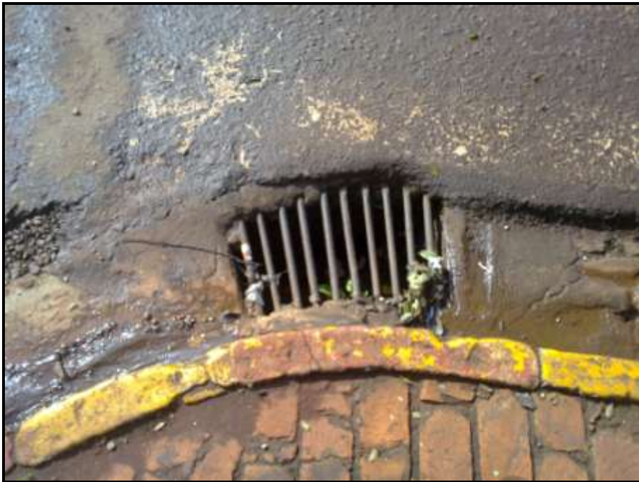
Figura 44: Caixa Coletora com gradeamento
