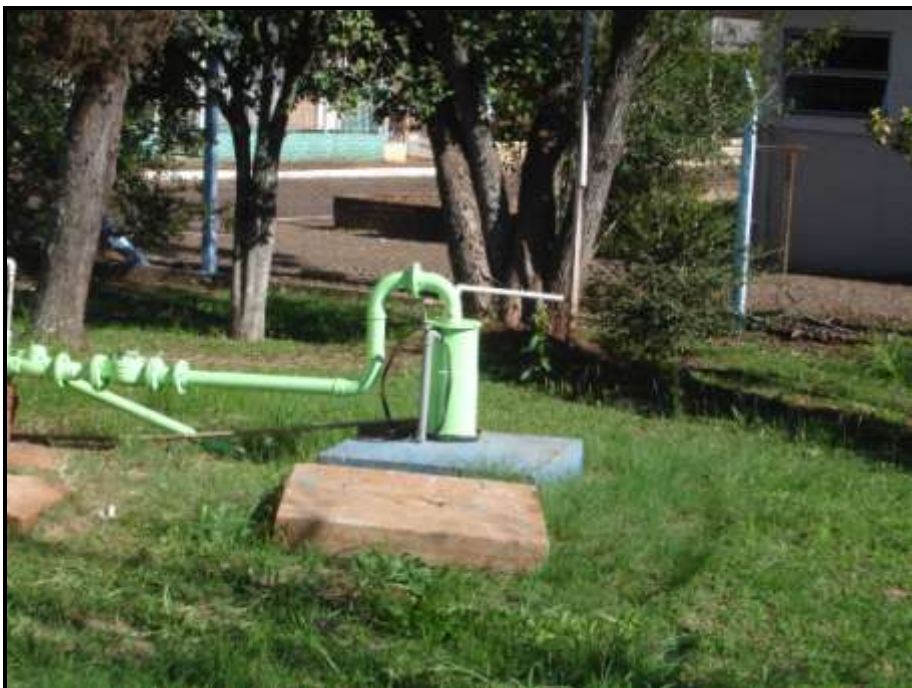
Figura 5 – Poço Corsan Bairro Santa Lúcia Fonte: Cerne Ambiental
