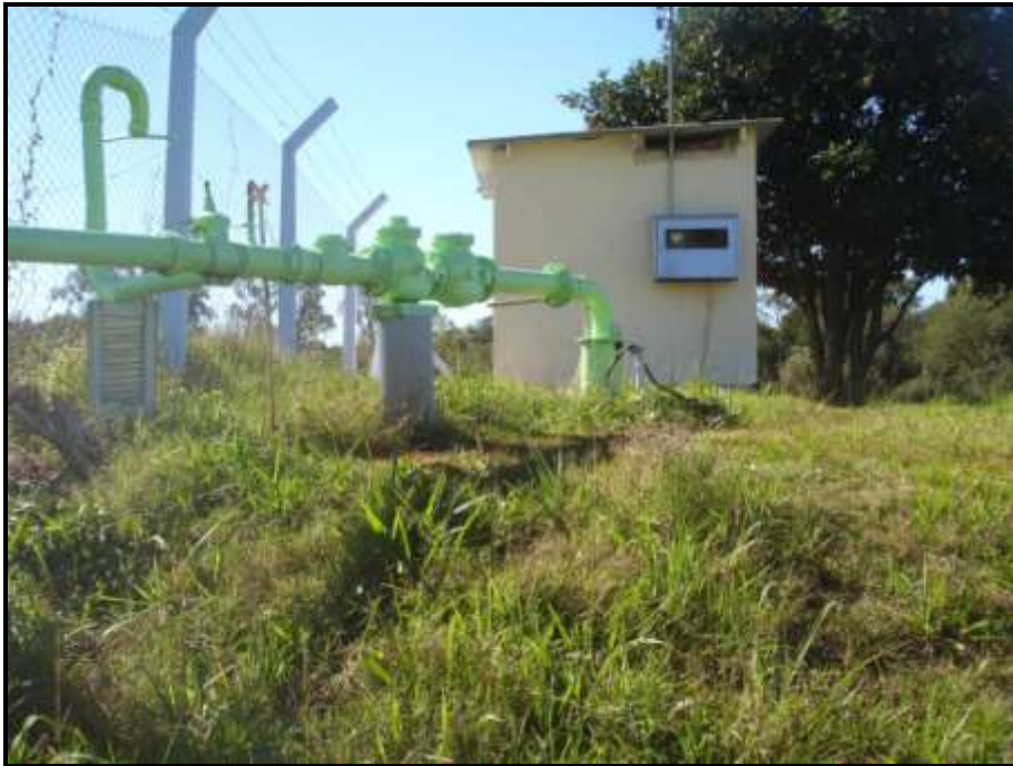
Figura 9 – Poço Corsan Distrito de Santana Fonte: Cerne Ambiental
