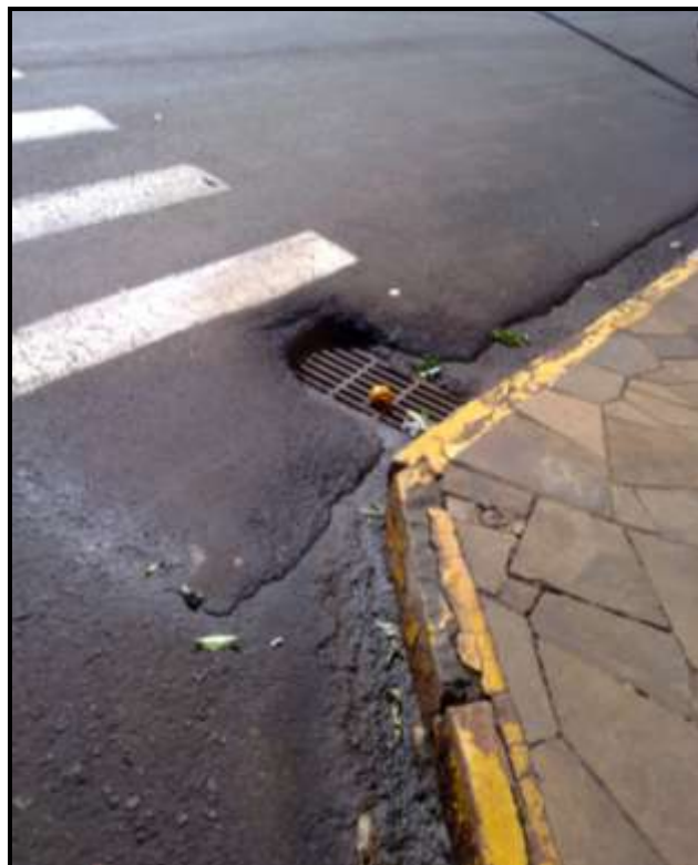
Figura 45: Caixa Coletora com gradeamento
