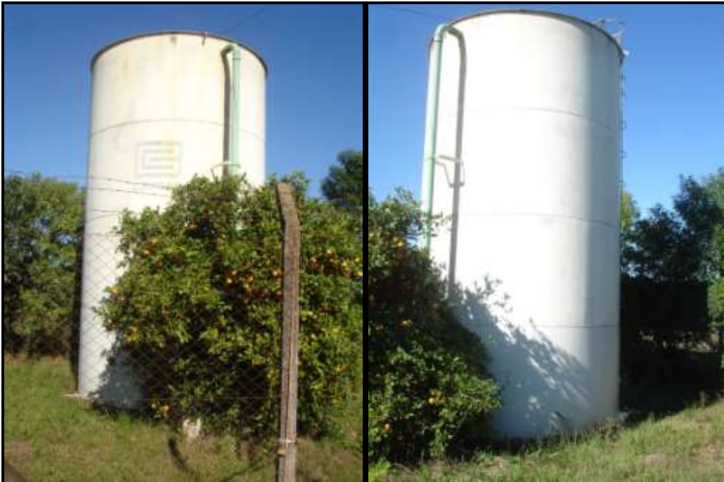
Figura 11 – Reservatório Corsan – Bairro Santa Lúcia
