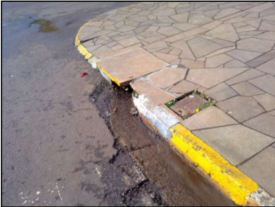
Figura 41: Boca de Lobo
